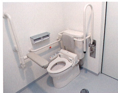
居室内トイレ
