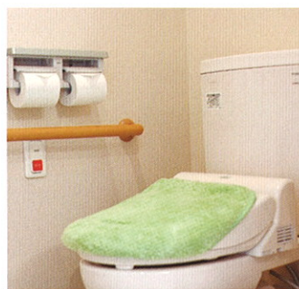
居室内トイレ
