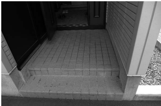
玄関タイル（弱視の方は目地を段差と誤認）
