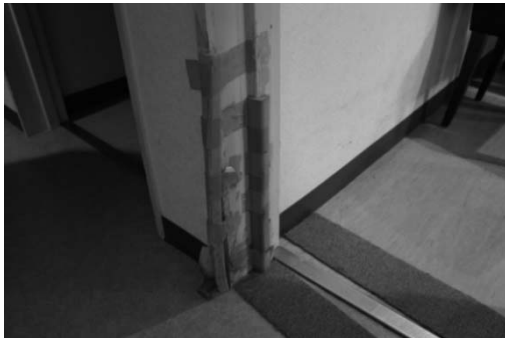
車いすがぶつかってできた損傷部分
