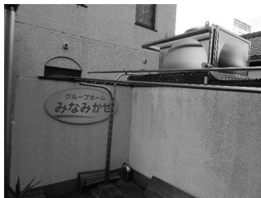
スプリンクラー用タンク
