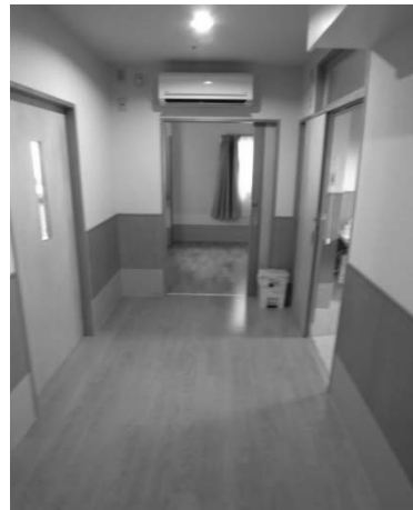
手すりのない廊下
