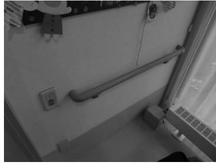
ホールの窓側に沿って設置されているヒーター（右下）
