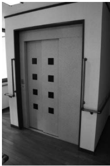
エレベーター
