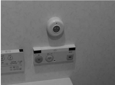
トイレ内のコール装置
