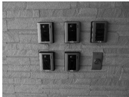
玄関に設置されたインターホン
