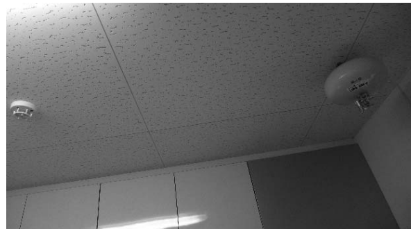
台所の天井に設置されたスプリンクラー
