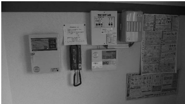
緊急通報装置
