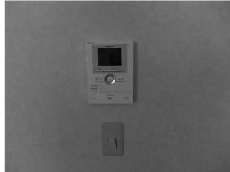
各居室に設置されたインターホン受信機
