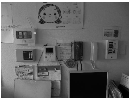
ヘルパーステーション内の火災警報受信機
