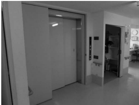
エレベーター
