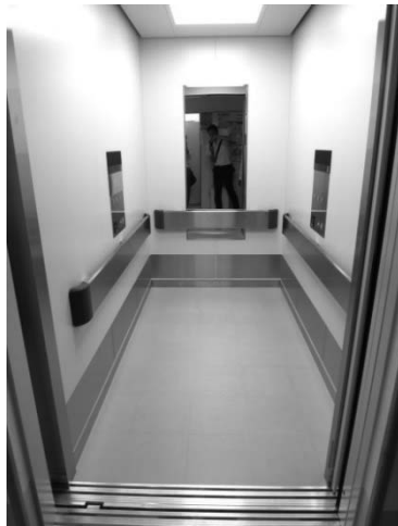
エレベーター（かご内）
