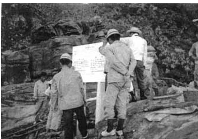
ボルトとナットで組み合 わせた警告板と支柱を穴 に建て、セメントとバラス を流し込んで根元を固め て、しっかりと建てる。
