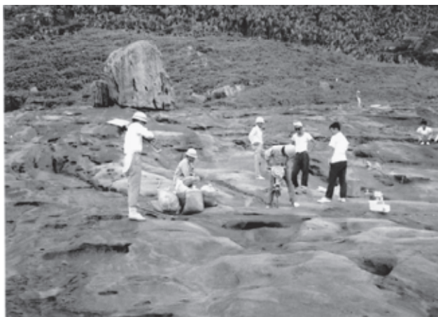
サンゴ礁の固い岩盤に 深さ 40 c m の穴を掘っ て、設置に取り掛かる。
