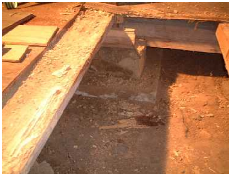
写真9. 玄関の板がシロアリの被害で抜けている
