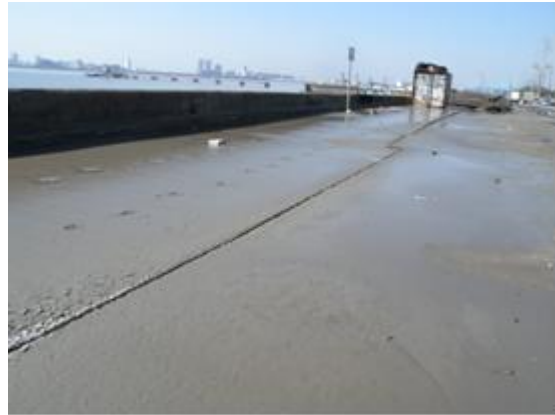
液状化で泥が吹き出した。道路に亀裂が入っている
