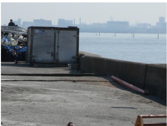
護岸が海側に膨らんでいた
