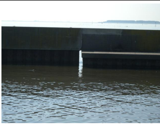
突堤に割れ目ができていた
