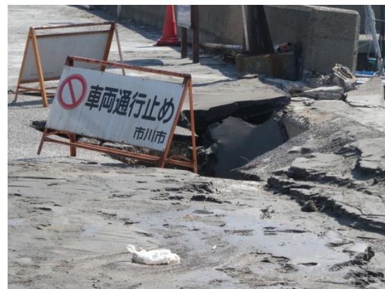
取り付け道路が陥没している
