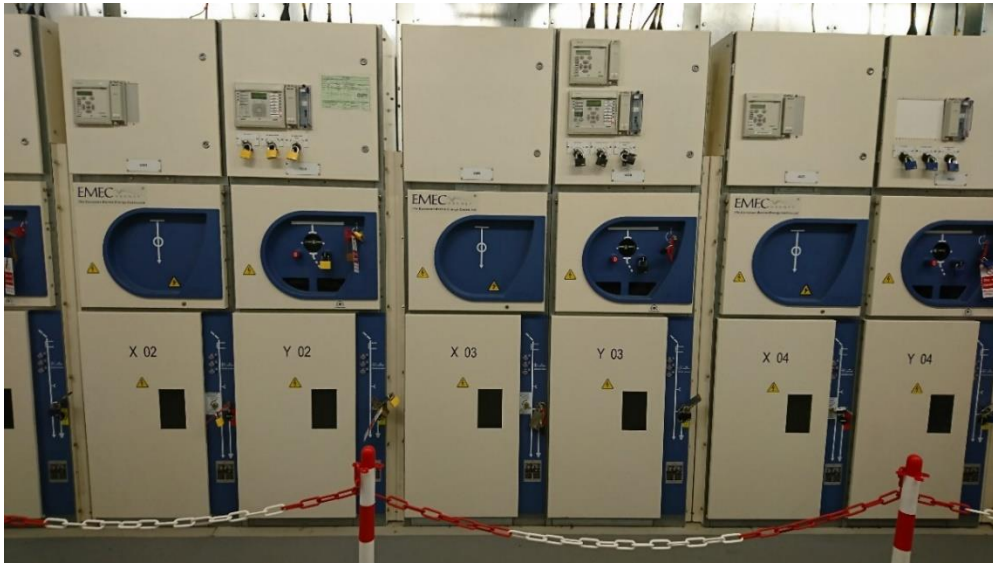
図9 変電施設の内内部
