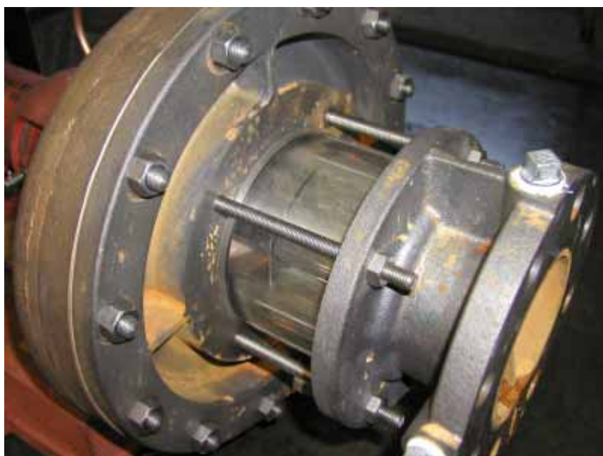
写真 5.1.3 低速型ポンプ吸込み部
