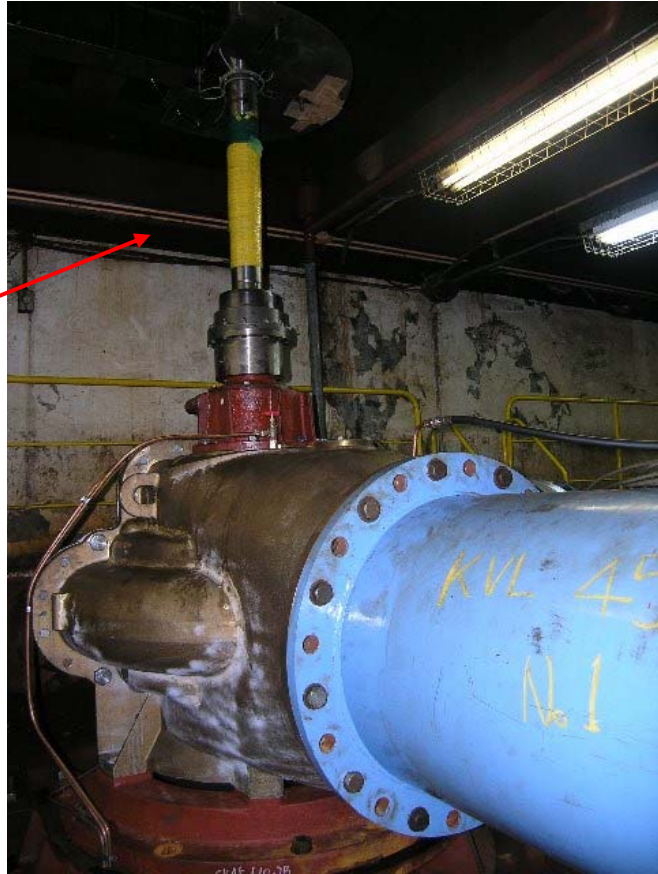
写真 36 試験中の負荷ポンプ
