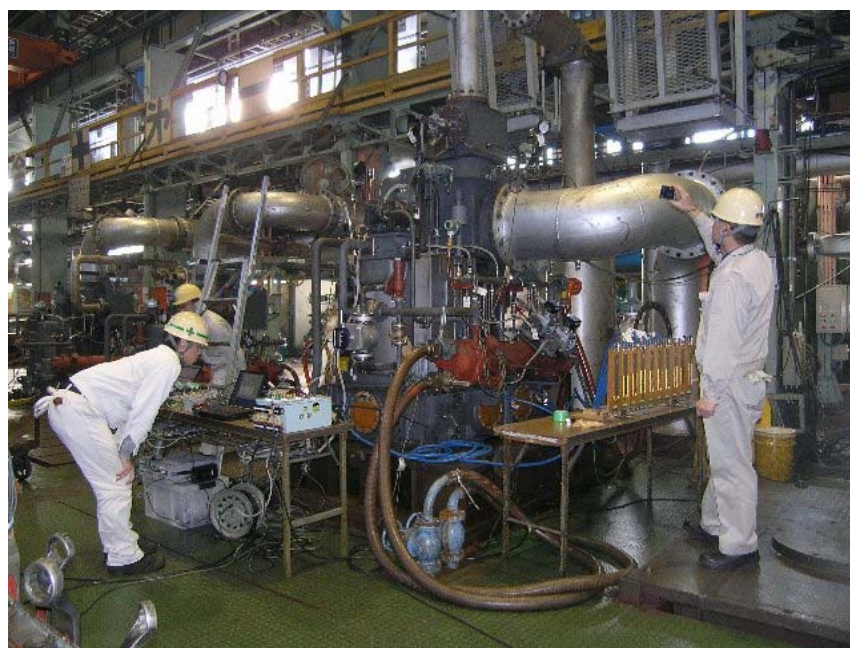
写真 35 試験中の蒸気タービン(その 2)
