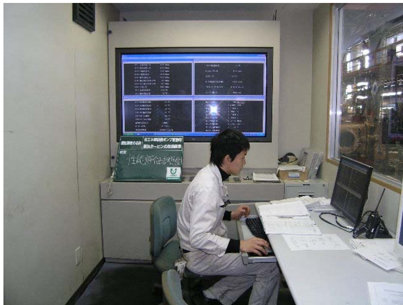
写真 37 試運転室 (正面スクリーンに計測値を常時表示)
