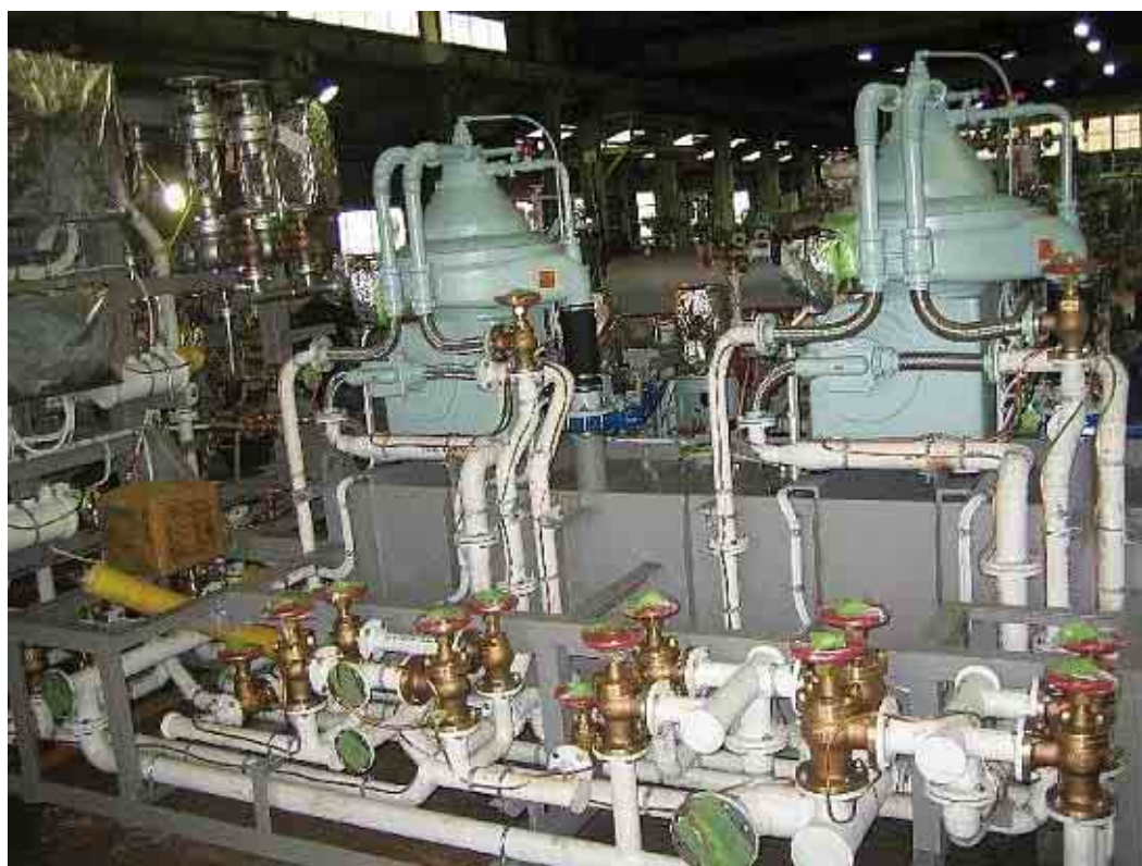
写真 2.1 B造船所（清浄機ユニット写真）
