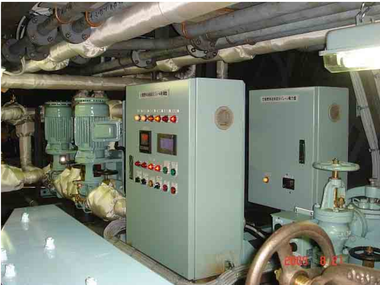
写真 4.6 実船搭載した主機燃料油供給モジュール
