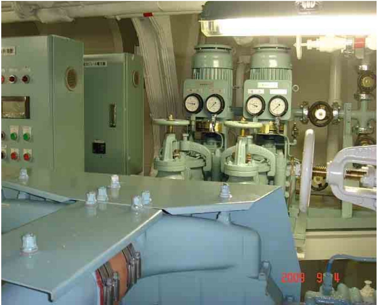
写真 4.11 燃料油移送ポンプモジュール実船搭載写真
