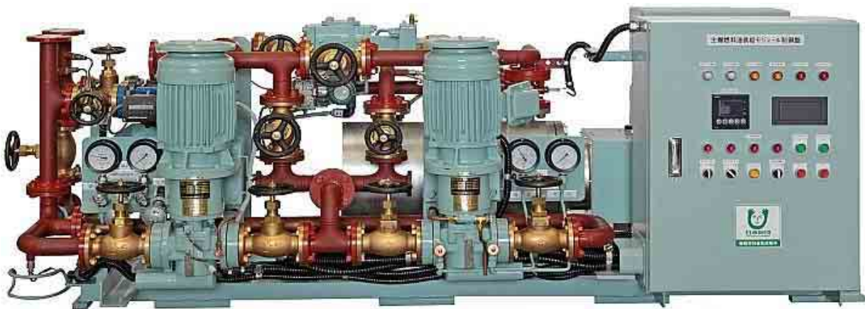
写真 4.2 主機燃料油供給モジュール正面
