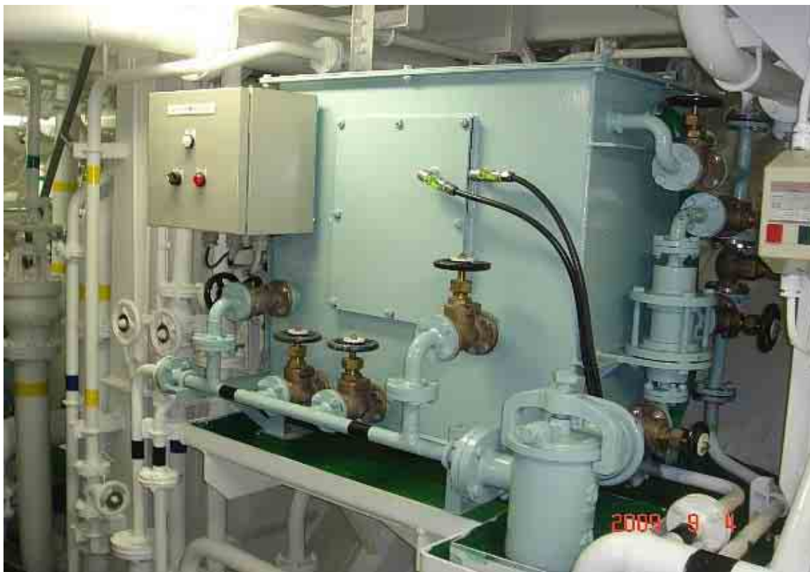
写真 4.8 ビルジ前処理モジュール実船搭載写真（出港時撮影）
