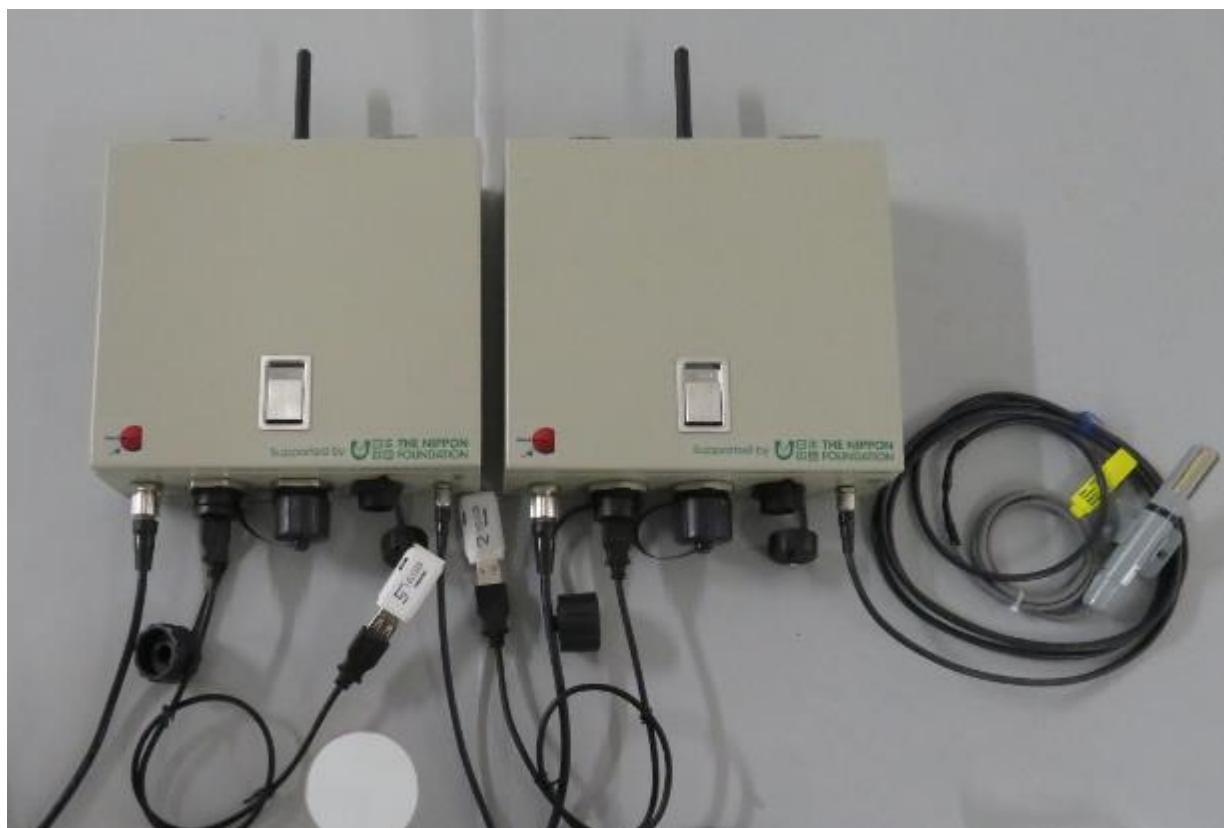
図 3-29 振動・傾斜記録装置 設置写真
