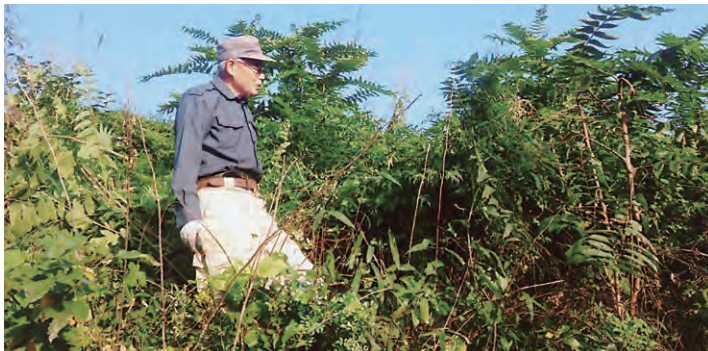
▲県道5号線（フルーツライン）のり肩とのり面の清掃活動は、急こう配で危険な作業
