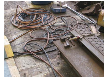
ガスホースと吹管と切り離した例
