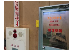
消火設備設置個所の表示例
