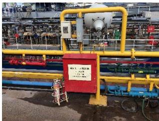
消防ホースの格納事例
