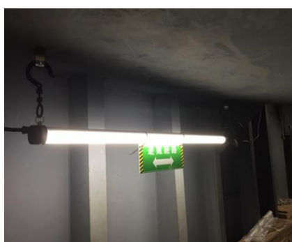
密閉区画内の照明と避難経路表示の例
