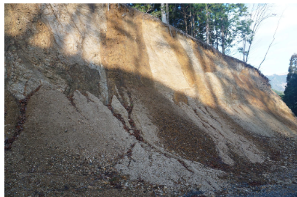
写真8 切土のり面脚部に形成された崖錐
