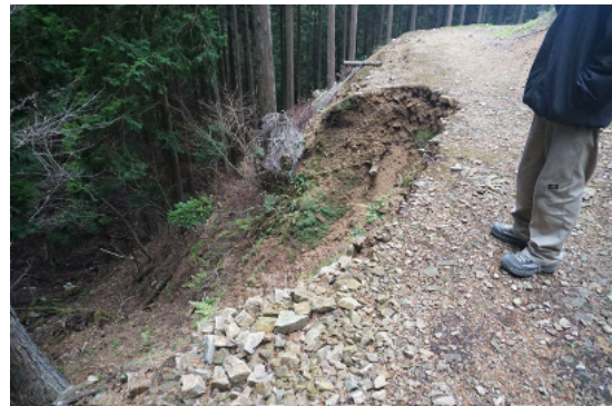
写真6 路肩の崩壊の状況
