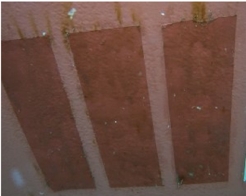
図45 水中カメラによる観察（1ヶ月後・上部塗装箇所 No. 1-3）
