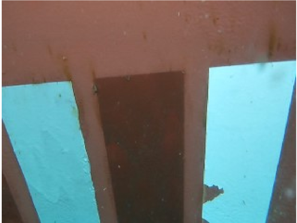
図4 6 水中カメラによる観察（1ヶ月後・上部塗装箇所 No. 4-6）
