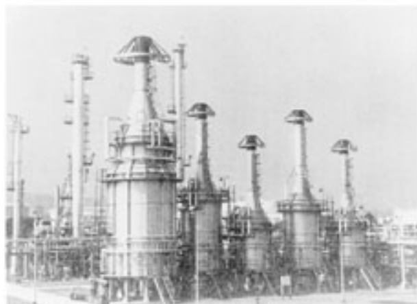
清水工場の接触改質設備（パワーフォーマー）
