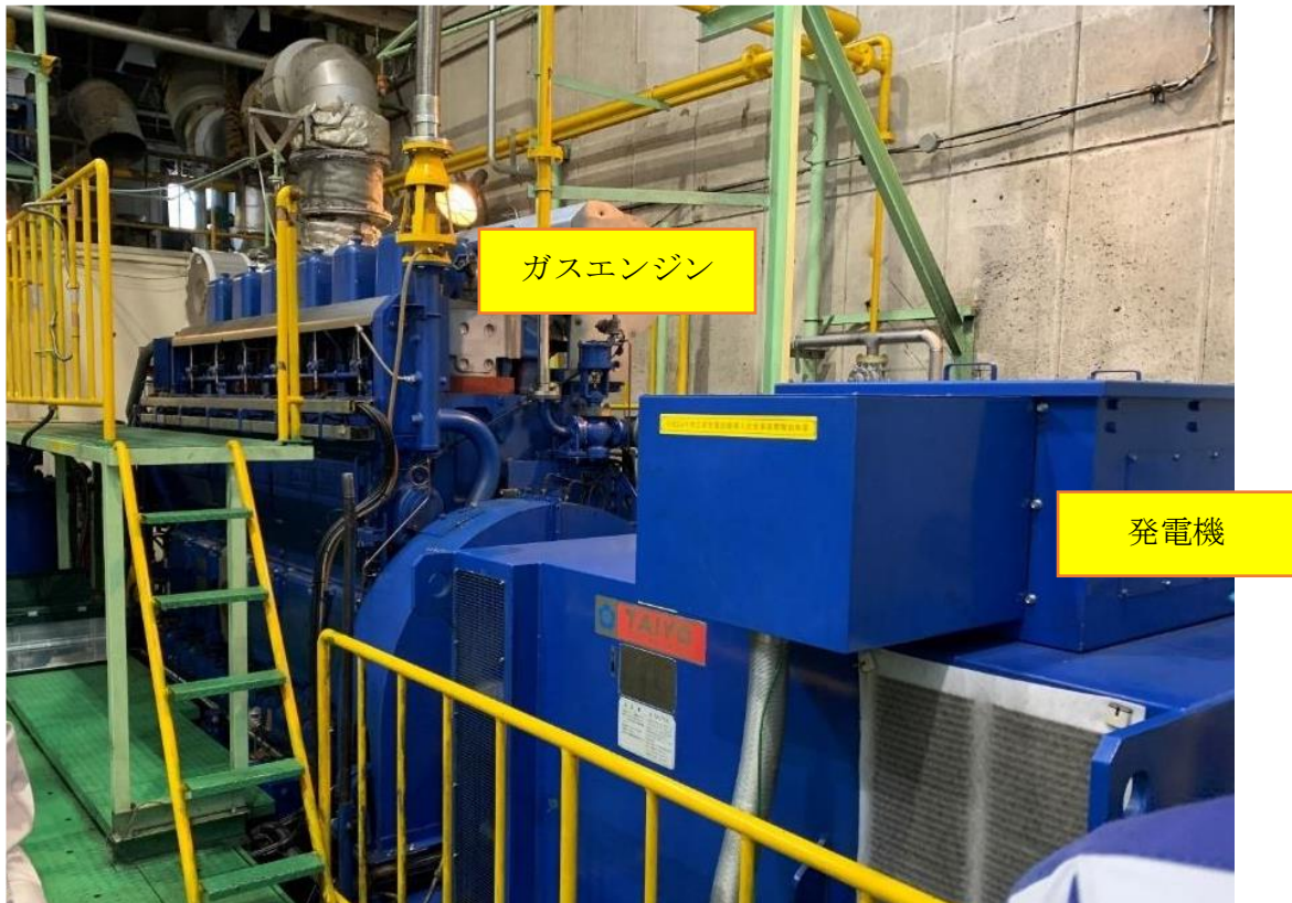
図 29 ガスエンジンと発電機全景
