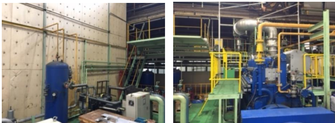
図 27 部屋の左端からガスエンジン 2 号機
