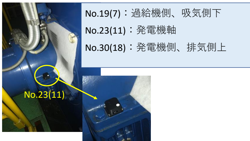
図 46 検証センサの設置場所（発電機）
