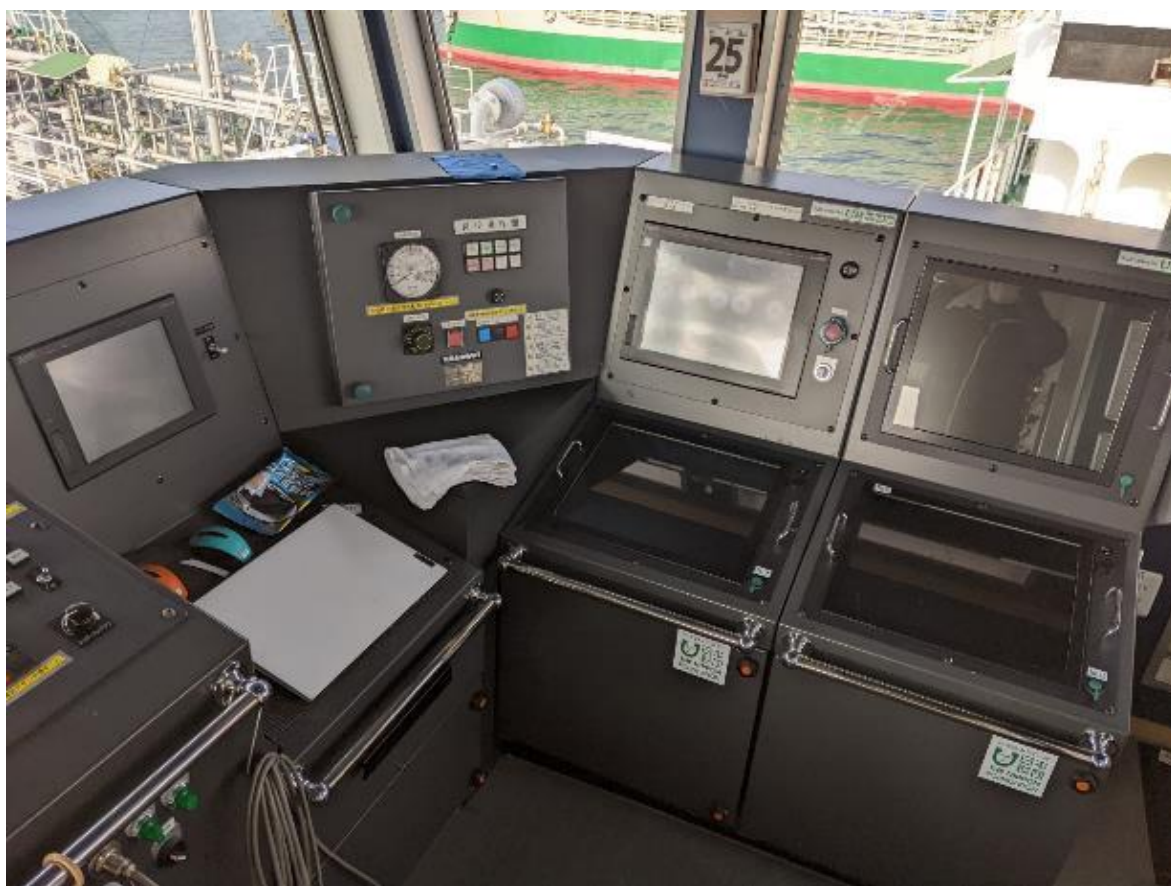
写真 19 荷役遠隔コンソール
