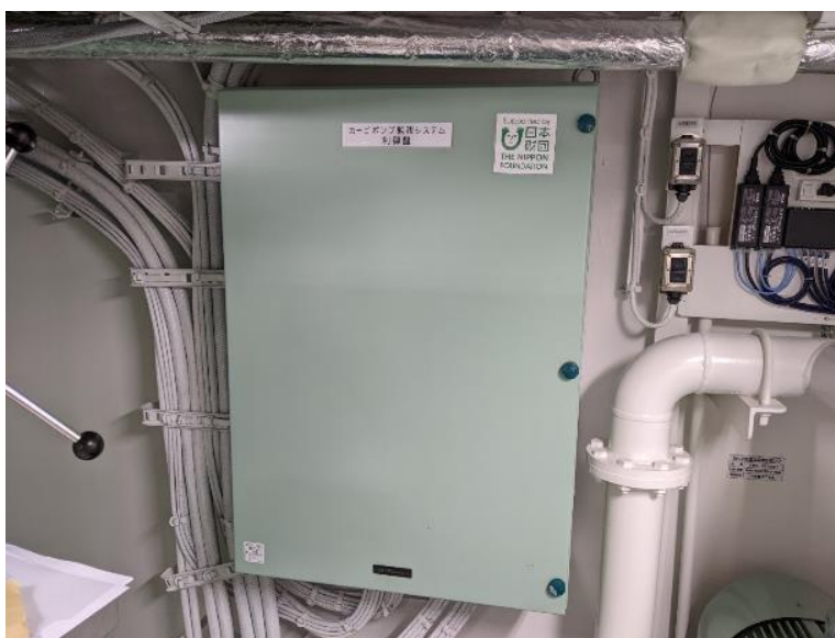
写真5 荷役ポンプ監視システム制御盤
