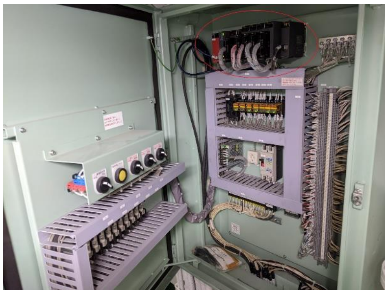
写真4 荷役ポンプ監視システム盤に組み込まれた圧力・電気変換機
