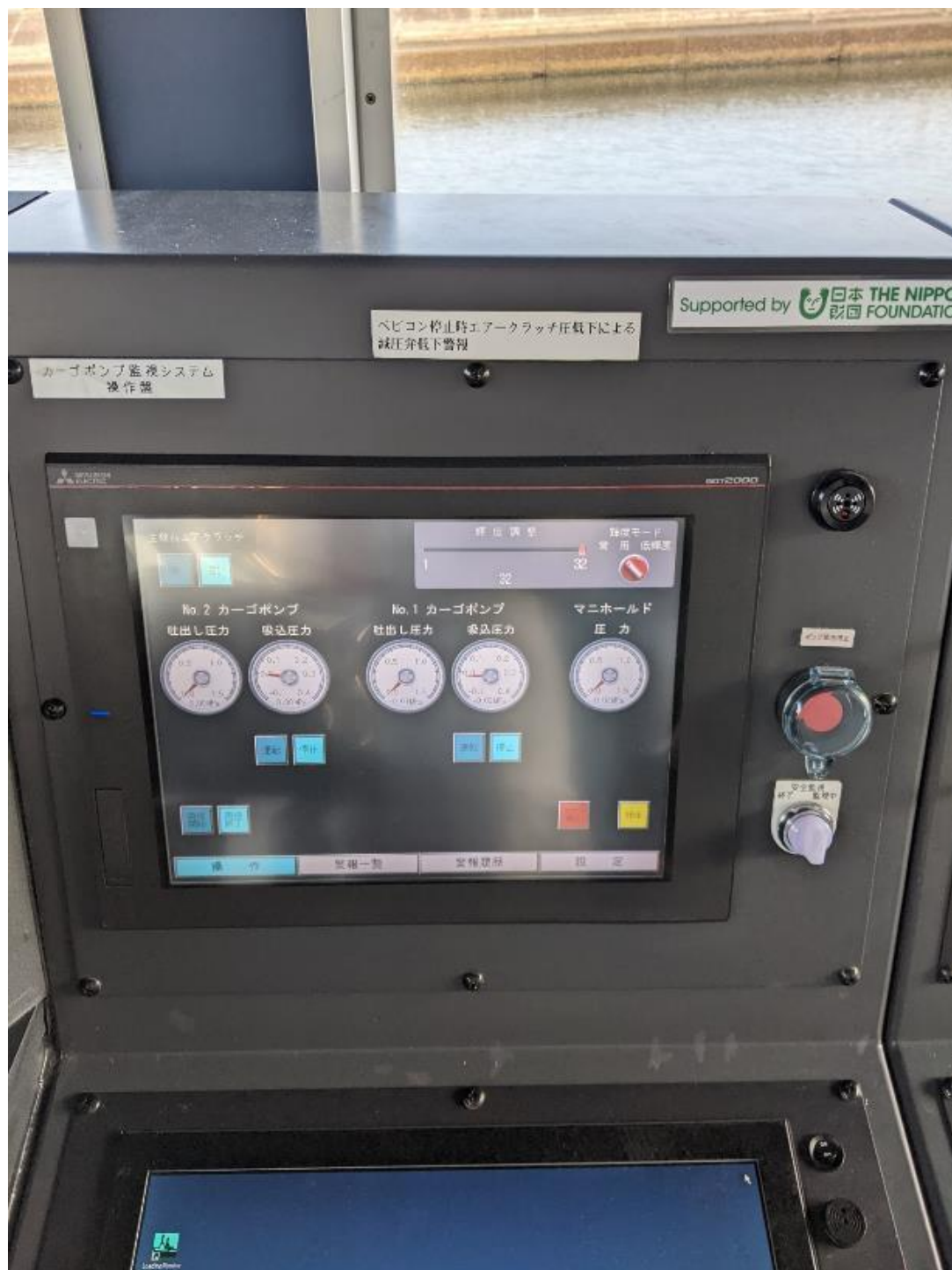
写真6 荷役ポンプ監視システム制御盤情報の表示
