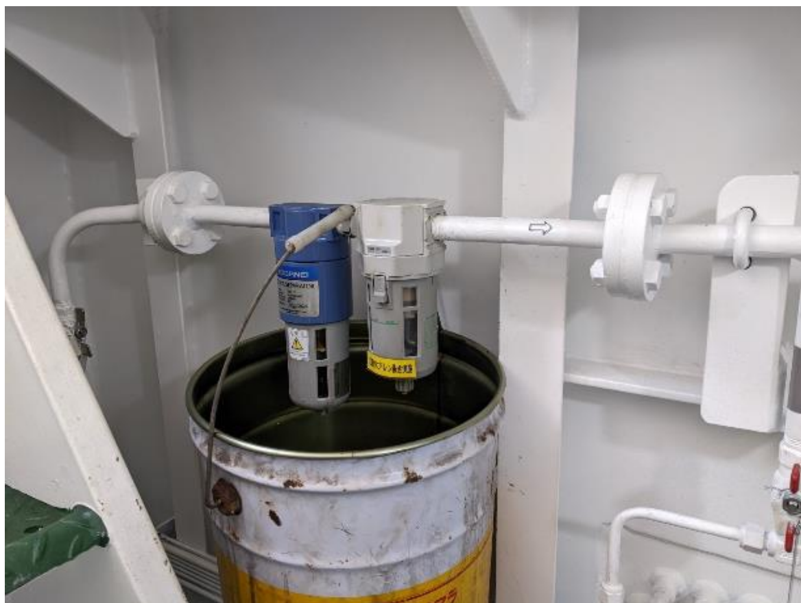
写真 11 空気配管に取り付けたオートドレン装置
