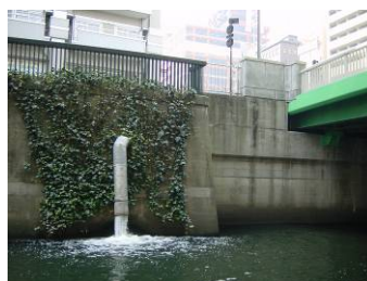
環境浄化に利用している地下鉄湧水
