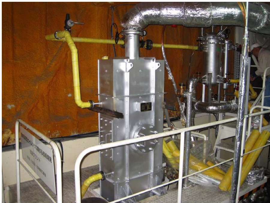
図 61 水圧試験中のサイレンサ B と（黄色の）循環ループ （左下の黄色の筒状物は、取り外した配管保温材）
