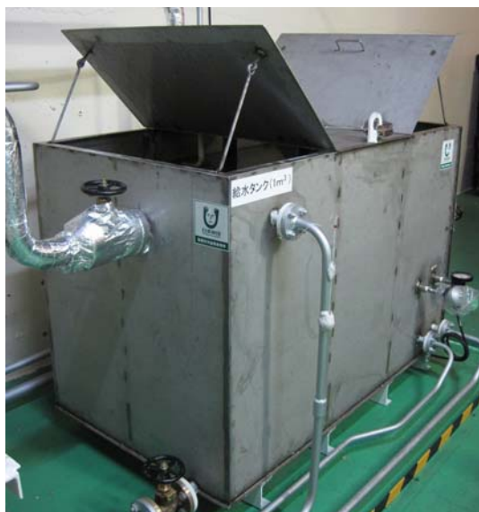
図14 給水タンク外観（給水、ドレンクーラー、ポンプ冷却系の配管が接続）
