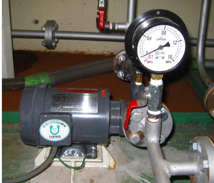
図 56 新設の小容量給水ポンプ
