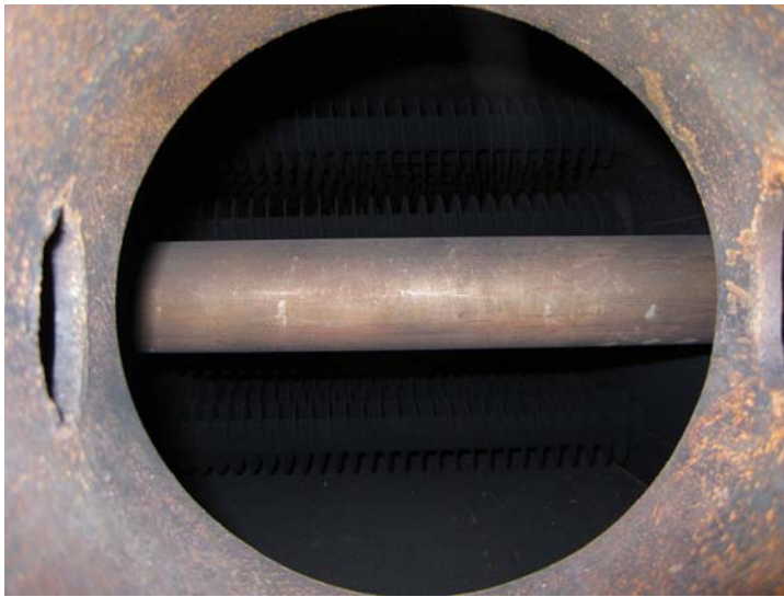
図 88 スートブロー用空气管（サイレンサ下方から見る）
