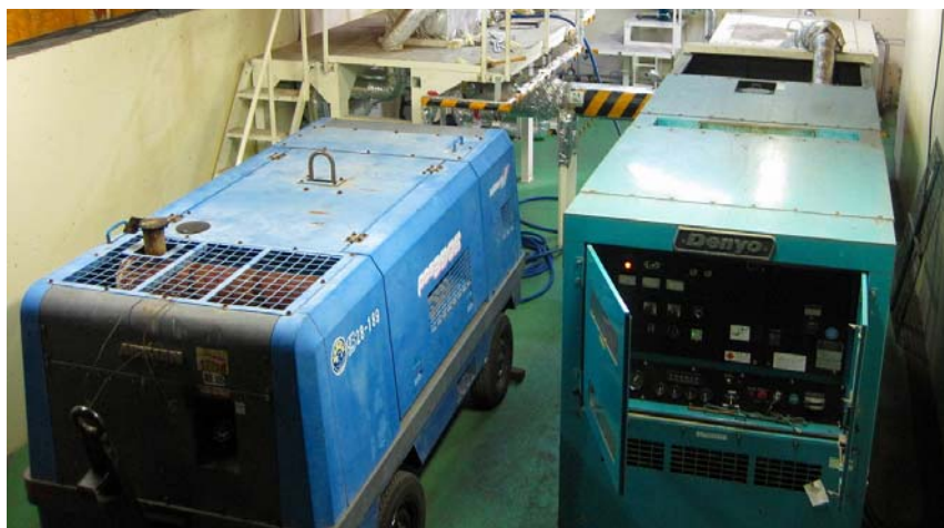
図 89 レンタルした車載コンプレッサー（左）、右は発電機関
