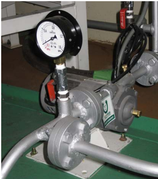
図 12 給水ポンプ（上）
