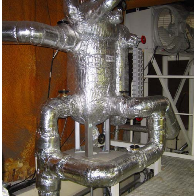
図 54 配管が一部追加された後の汽水分離器（下方の水平配管が追加）
