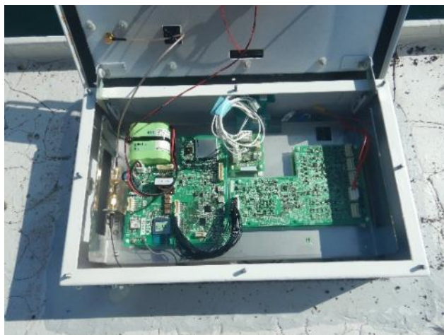
図-52 筐体内部状態
