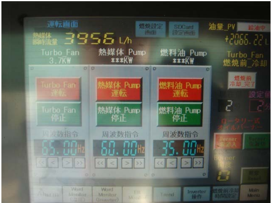
写真 4.45 排ガス熱交換器陸上性能確認試験用ポンプ、ブロー等制御盤モニター
