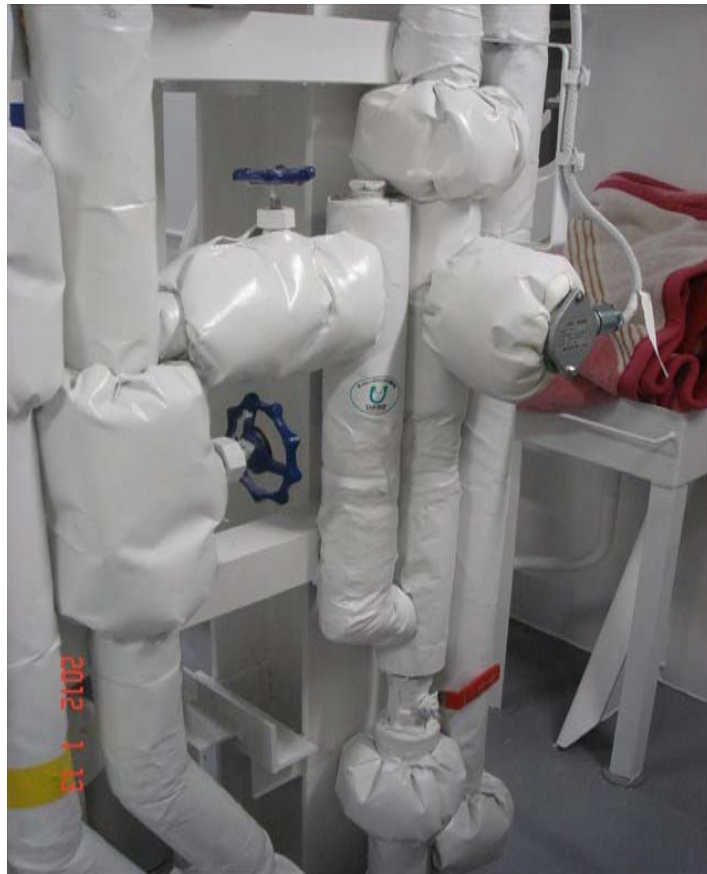
写真 5.56 漏洩検知器搭載時
