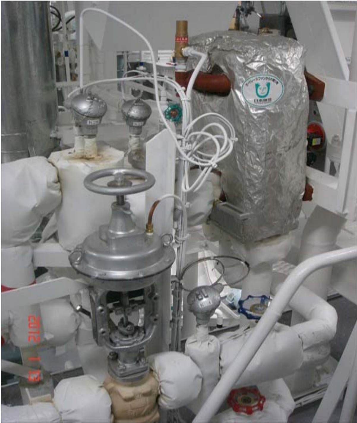
写真 5.57 熱媒油熱交換器及び温調弁搭載時
