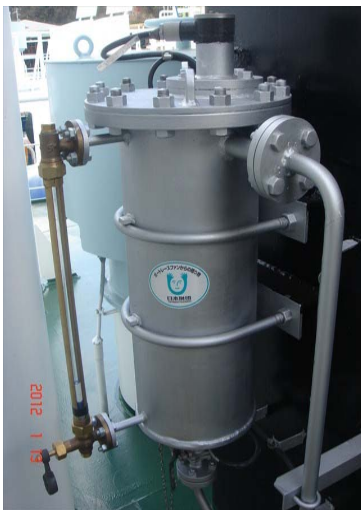
写真 5.50 熱媒油膨張タンク搭載時
