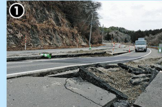
地震から2カ月たっても残る道路の激しい亀裂や段差
