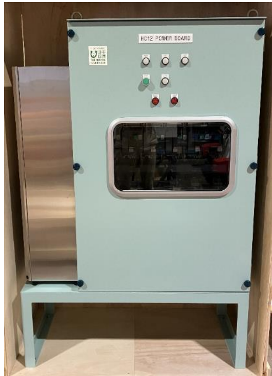
図 3-2 コントローラユニット・ROV 制御盤完成写真
