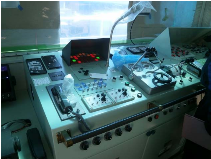
電気計器部 動作確認
