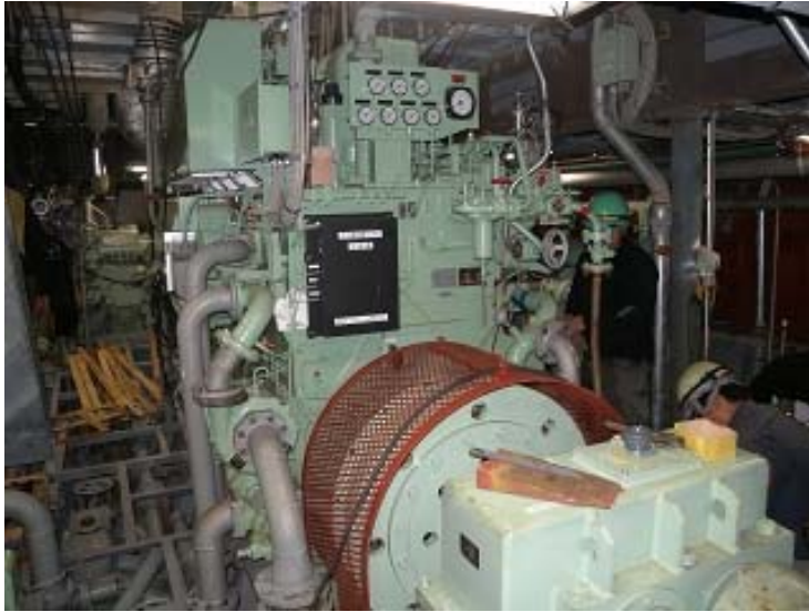
主機関起動・確認
