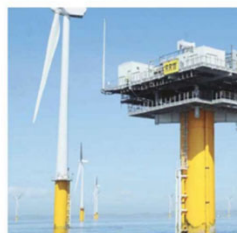
海上変電所建設及び送電線敷設 (電気設備は国内規格に準拠)
