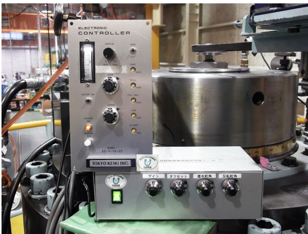
写真 4. 1. 4-6 負荷制御用コントローラ、負荷調整ユニットの配置 上が負荷制御用コントローラ 下が負荷調整ユニット
