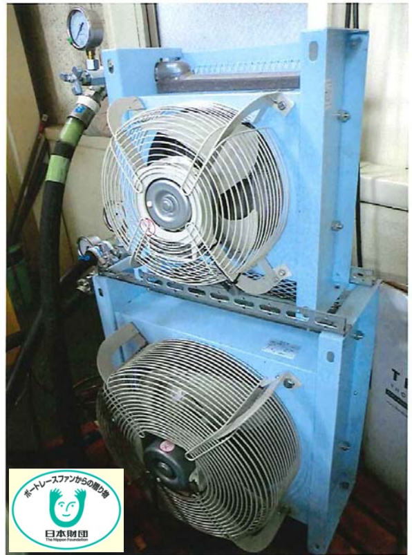
写真 4. 1. 4-8 作動油冷却用クーラー
