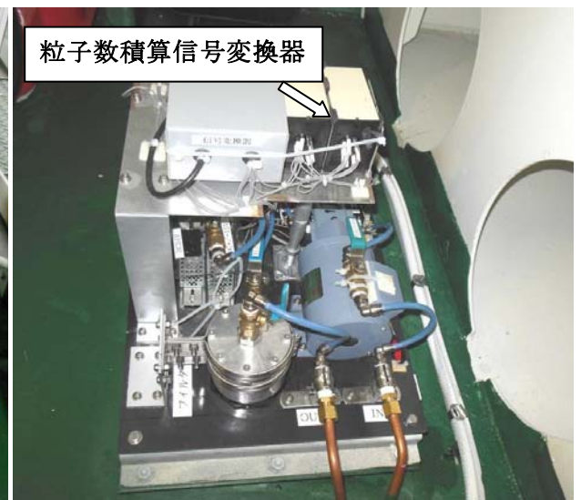
図 4.10.2.6 計測ユニット箱内部 (2)
