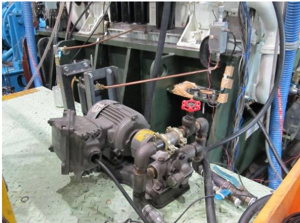
図 4.3.1.2 測定装置機側全景
