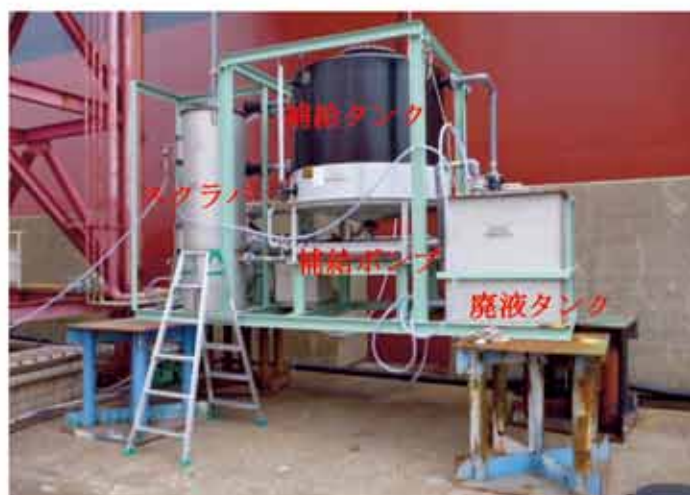
図 6.2.2.1 ポンプユニット
