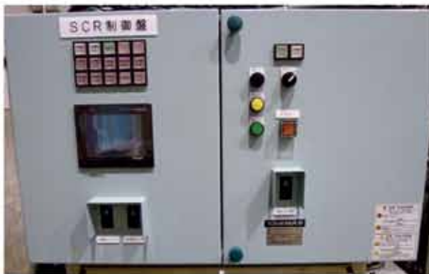
図 2-18 SCRシステム制御盤
