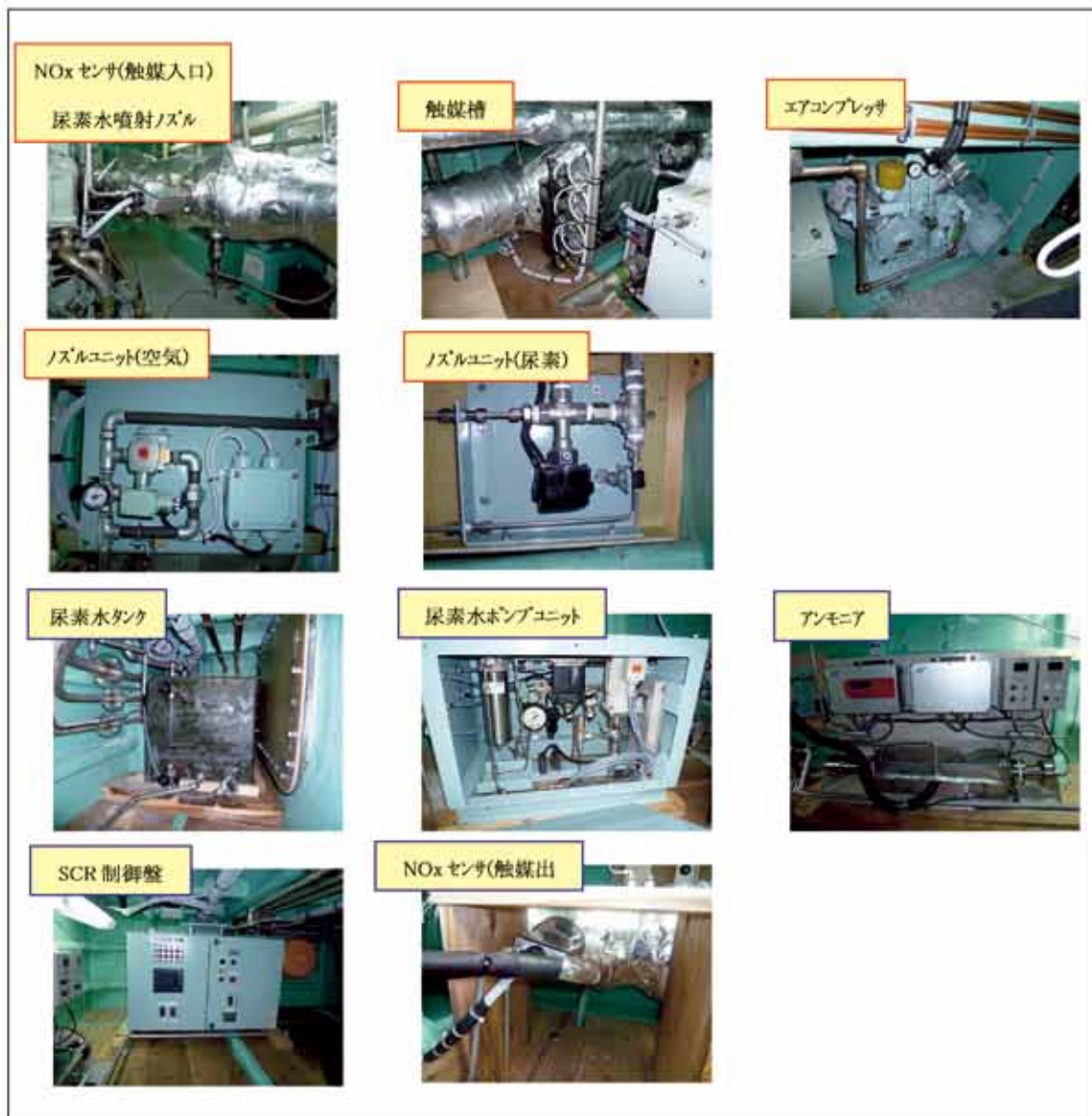
図 3-4 各機器設置状況(外観)(赤：機関室内、青：舵機室内)
