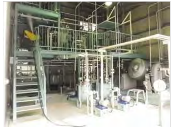
図7. リグノフェノール製造実証装置
