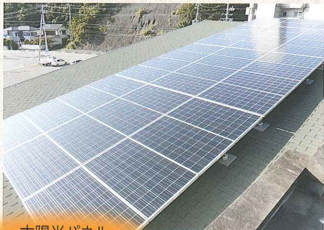
太陽光パネル
