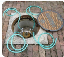
地下式給水栓
