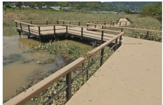
写真 7.6.2 木道手すりまで出水
