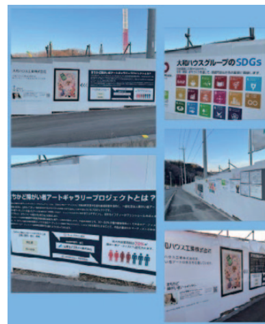
大和ハウス工業株式会社様 【建設現場仮囲い（埼玉県飯能市）】
