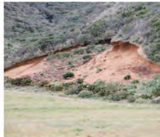
▲土砂の崩れの山肌、豪雨の爪痕が残る
