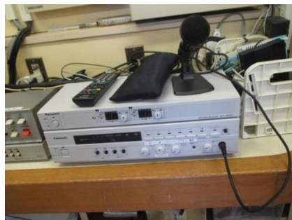
事務所内のアンプ 放送設備
