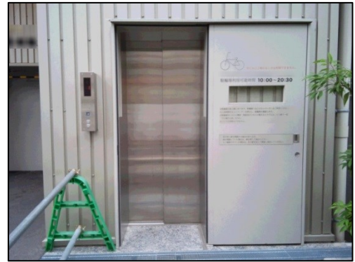
図表 2.60 屋上駐輪場用のエレベーター
