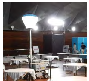
会場内 仮設照明 (左・移動式、右・タワー型)
