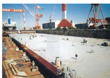
造船所で浮体ユニット建造 (ユニット寸法：長さ約300m幅60m)
