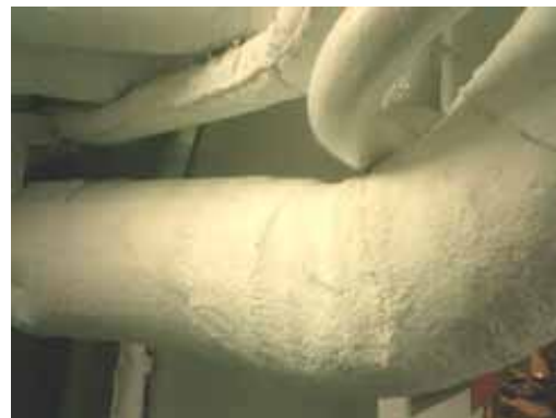
(アスベストクロスを蒸気配管に巻いている)
