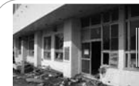
▲湊幼稚園・保育所被災写真 市立29箇所中、全壊等により9箇所の保育所が休止しました。
