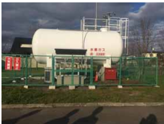
図表 5 - 30 水素貯蔵タンク
