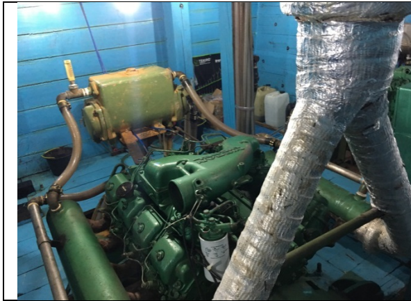
前頁漁船の主機 (中古トラックエンジン)
