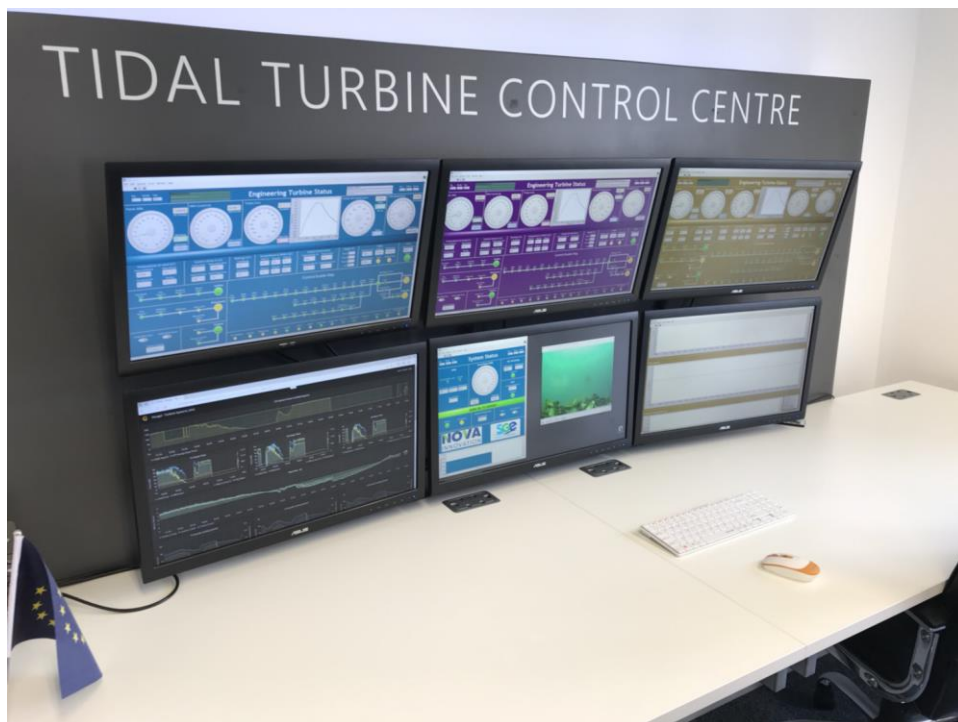
図 43 コントロールセンター
