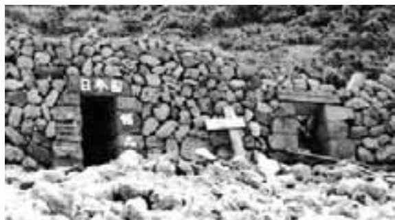
東楼門一角が崩落している。内側部分の石積みがこの一角から崩れ出していることを示している。(恵忠久 1996)
