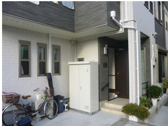
設置後(スプリンクラー機器)
