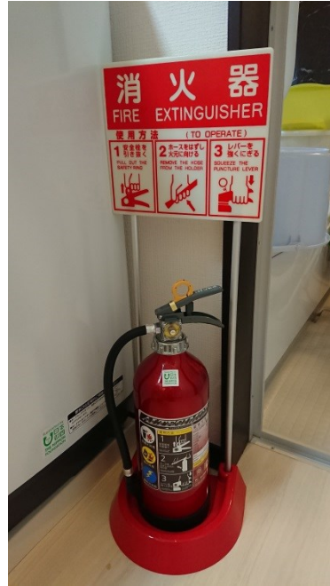
消火器 2階脱衣所
