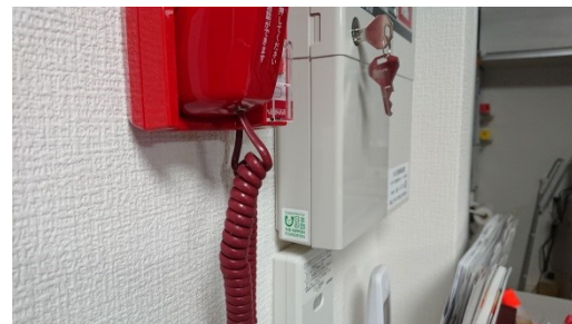
自動火災報知機・自動火災通報装置
