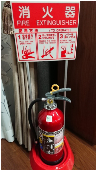
消火器 1階リビング
