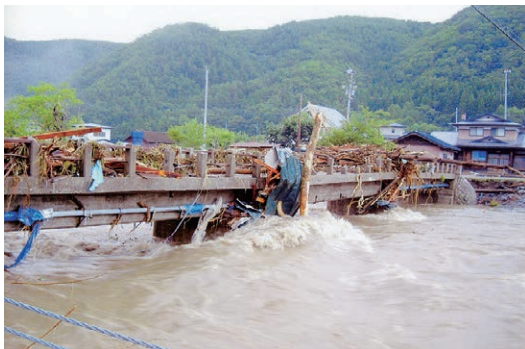
▲翌日の被害状況。橋の上に水流と流木が確認できる
