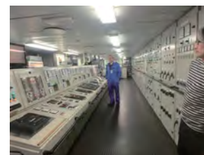
エンジンコントロールルーム
