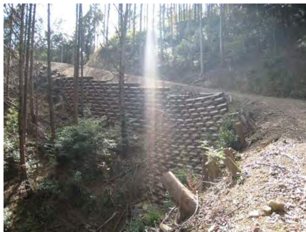
大規模施業者の作業道 盛 土上に敷設された木組み アンカーの役割をしていない
